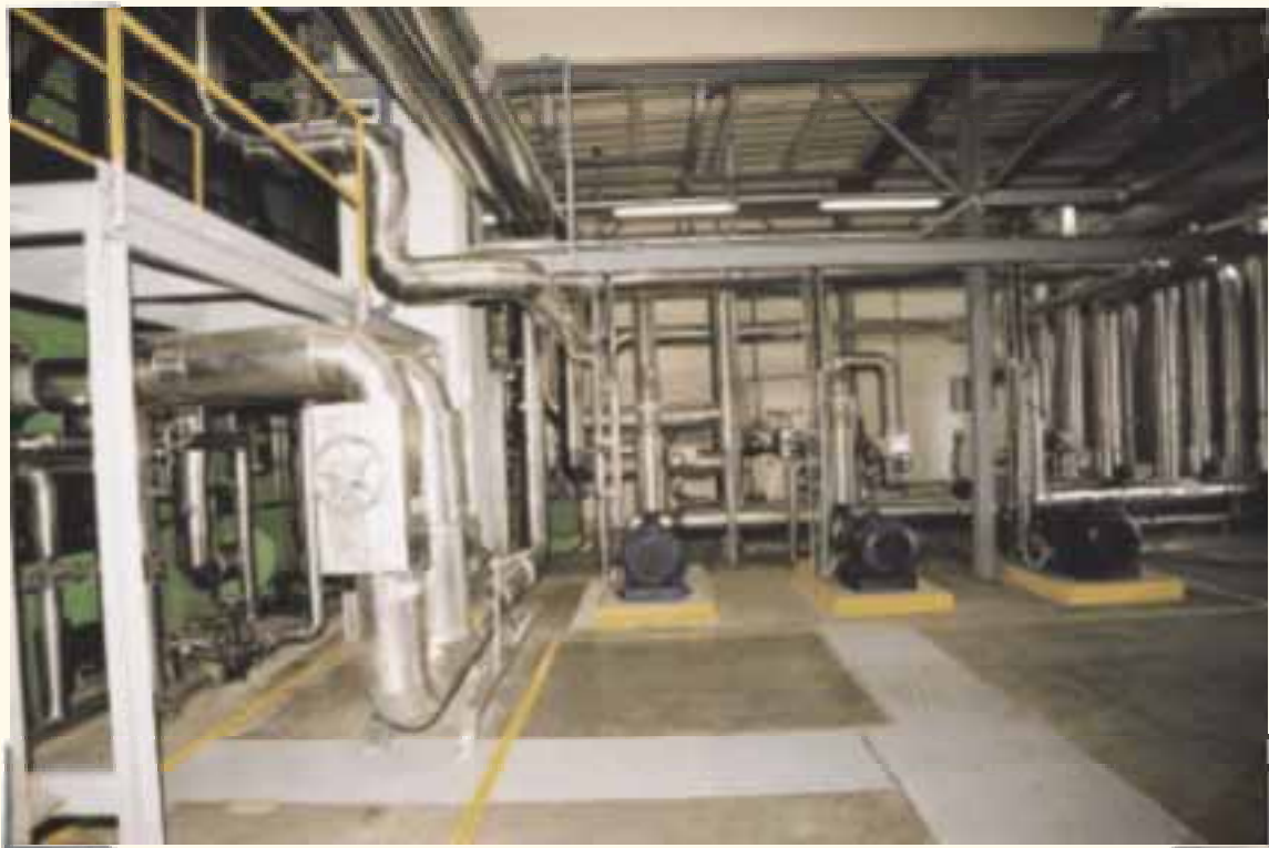
Ekologická kotelna pro spalování biomasy, Bystřice nad Pernštejnem Ecological boiler plant for biomass incineration, Bystřice nad Pernštejnem
