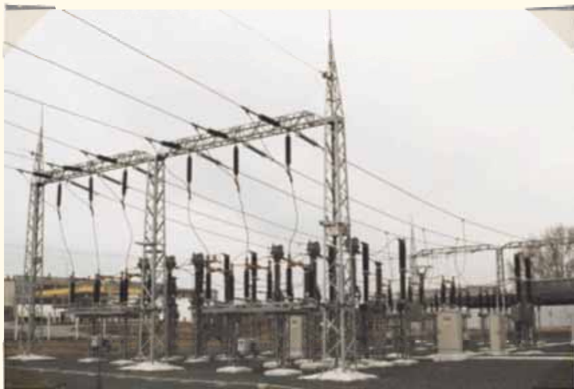
Trakční napájecí stanice Modřice Modřice traction supply station
