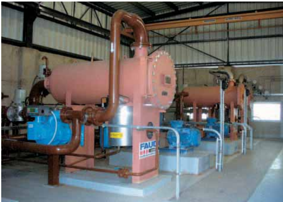
Čerpací stanice s koalescenčními filtry a odstředivými čerpadly
