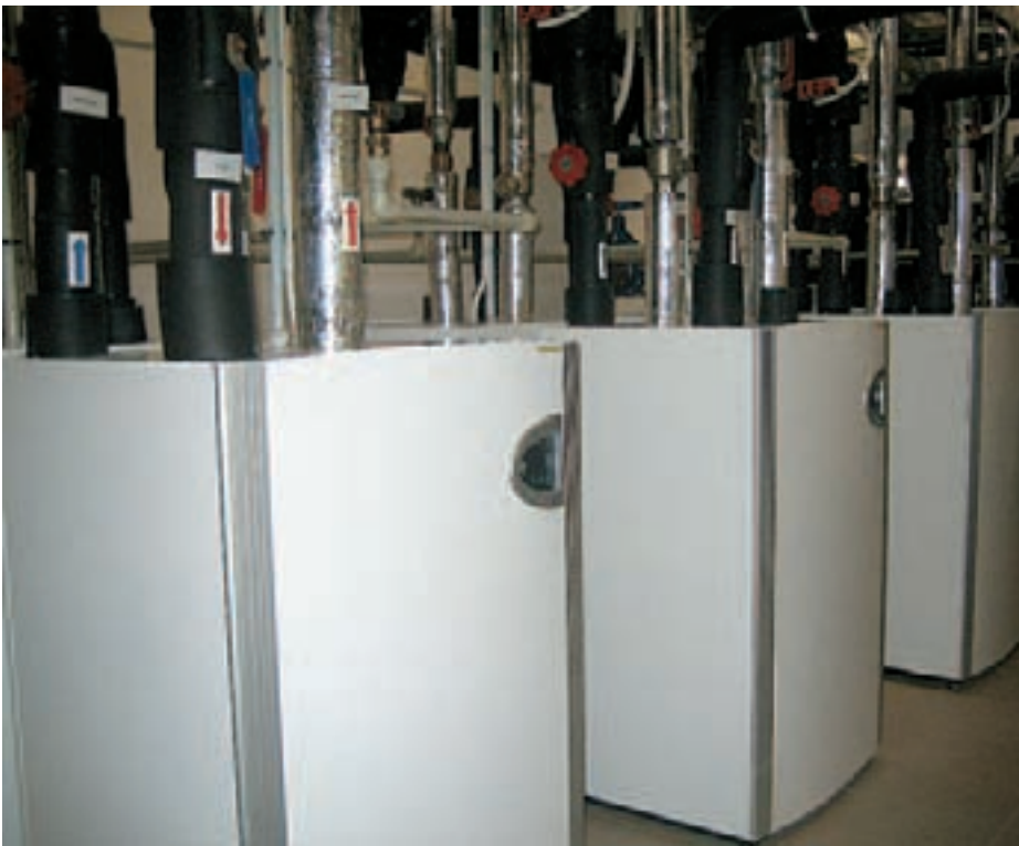
Strojovna tepelných čerpadel IVT země/ voda s celkovým výkonem 689 kW
