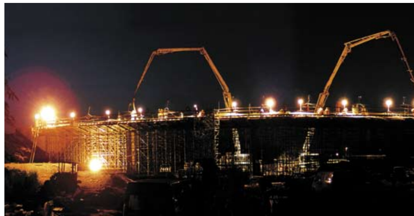
Silniční objekt SO 207 - velmi vysoké denní teploty si v letních měsících vyžádaly noční betonáž nosné konstrukce
