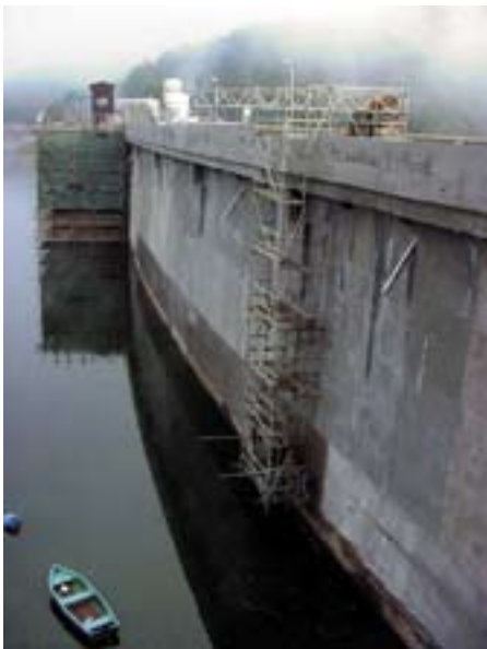
Zavěšené pojízdné lešení na pravobřežní straně hráze
