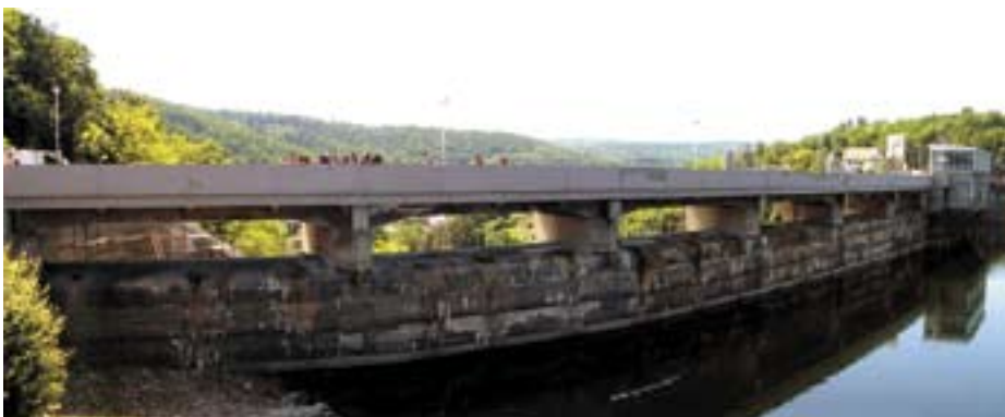
Původní stav návodní strany přehradní hráze vodního díla Vranov poškozené povodněmi
