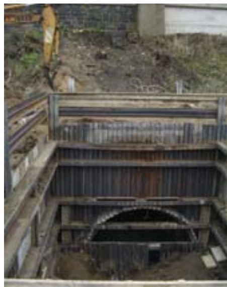
Obr. č. 4 - hloubení jámy Š1 vedle již zasypané Š3 - v pozadí podcházená železniční trať
