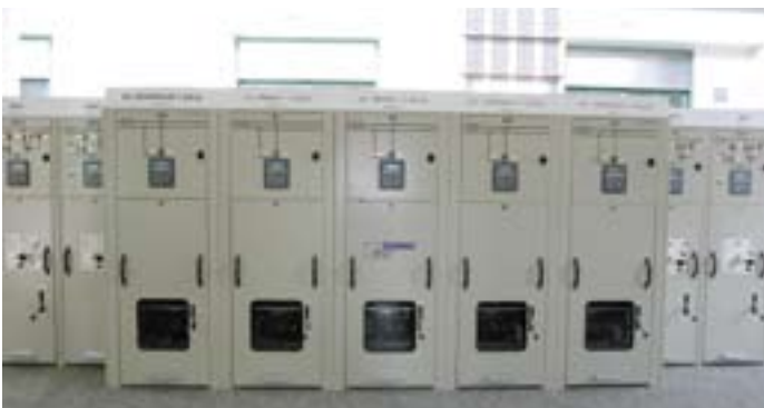
Rozváděč 22 kV AC - MR Grygov
