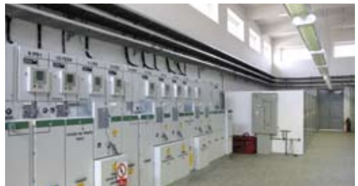
Rozváděč 3 kV DC - MR Grygov
